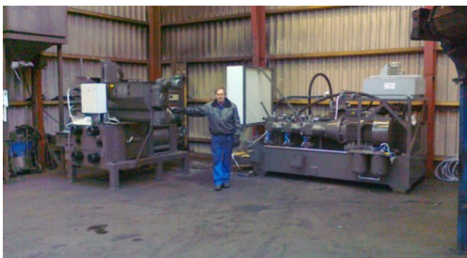
Briketpresser ved installering for ca. 10 år siden
